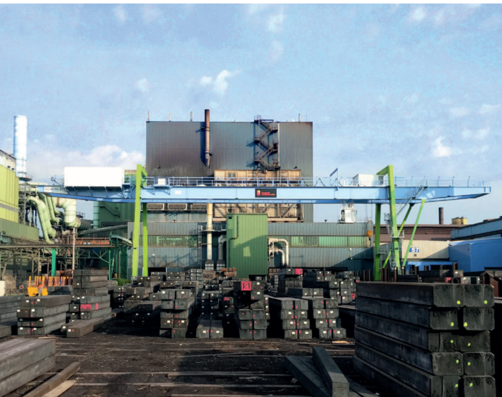
Der generalüberholte Portalkran wurde im Freilager von DEW Witten aufgebaut, um die Stahlblöcke zu transportieren (Foto: Teichmann Krane)
